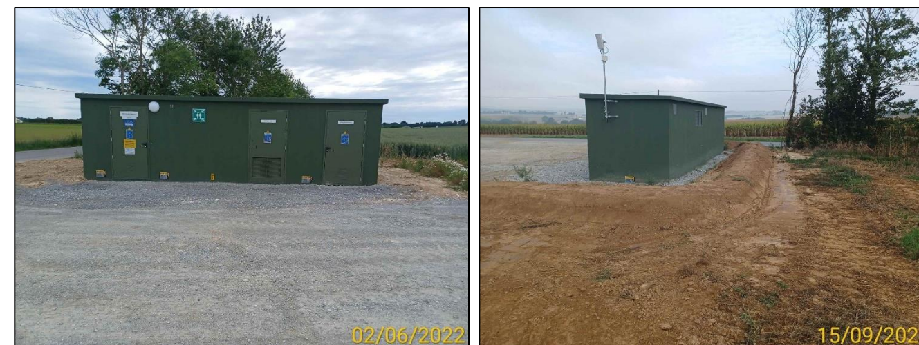
Figure 43 : Exemples de vues extérieures d'un poste de livraison (Source : Energiequelle)
