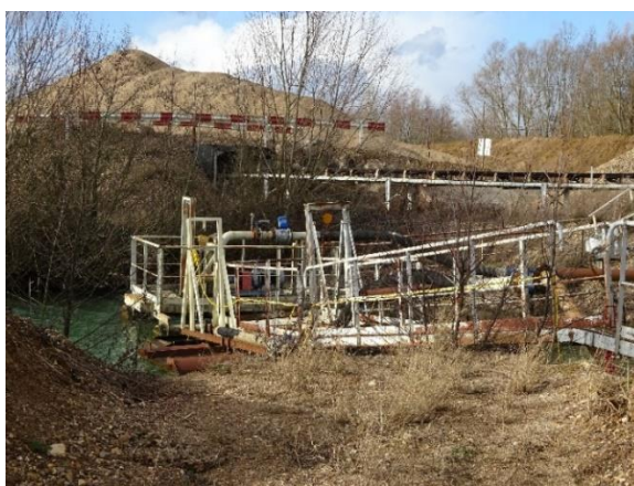
Figure 16 : Pompe immergée permettant d'alimenter l'installation en eau (ENCEM)
