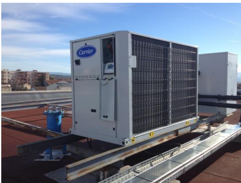
Figure 24 : Pompe à chaleur Air/Eau en collectif en toiture. Source : CARRIER
