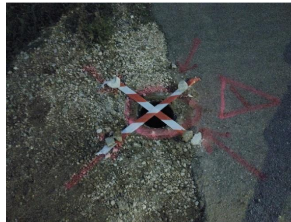
Regard ouvert à combler (trottoir côté entrée ouest).
