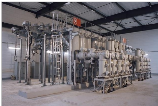
Vue d'un poste sous enveloppe métallique
