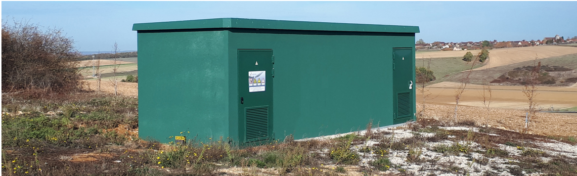
Poste de transformation/livraison : installations similaires
