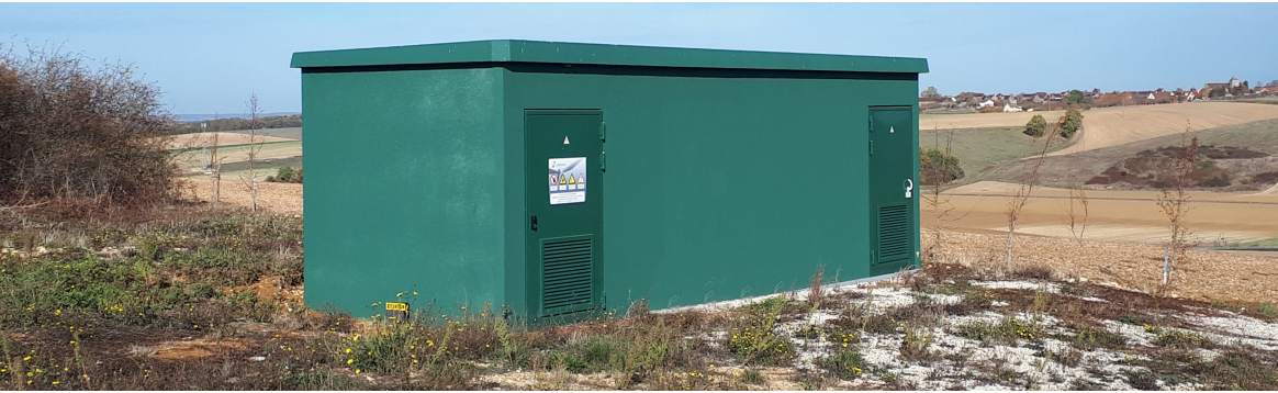
Poste de transformation/livraison : installations similaires
