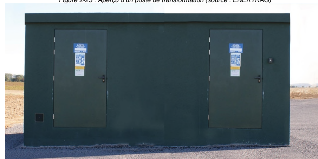
Figure 2-23 : Aperçu d'un poste de transformation (source : ENERTRAG)
