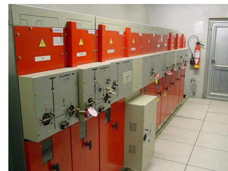
Illustration 11 : Intérieur d'un poste de livraison
