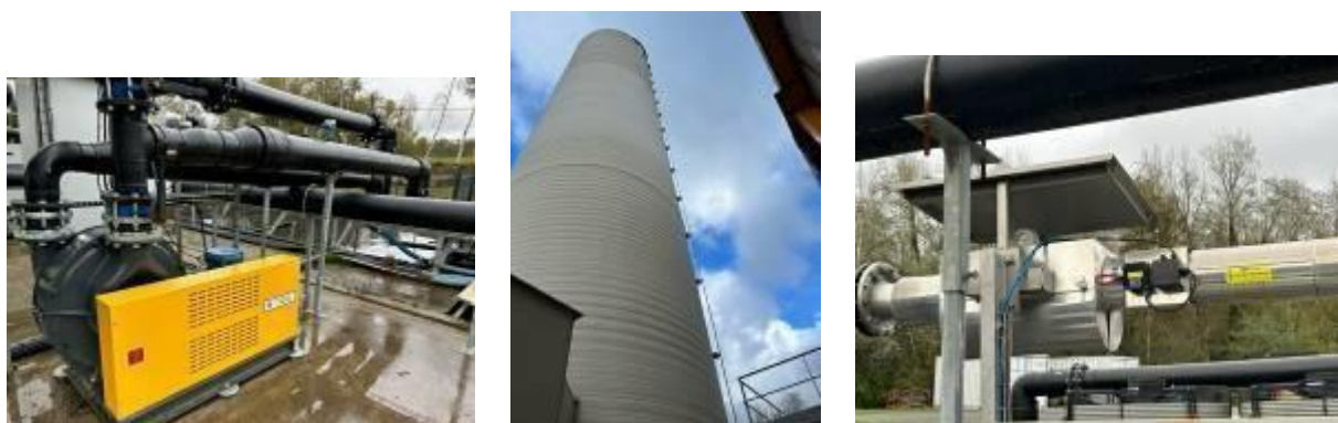
Figure 2 : Surpresseur avant traitement - tour de désulfuration – dévésiculeur avant séchage à froid
