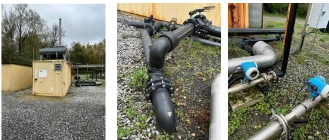
Figure 3 : container de cogénération avec canalisations munies de sondes de pressions, et débitmètres certifiés ATEX
