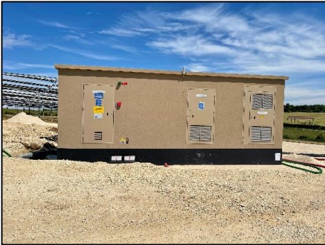
Exemple de poste de livraison
