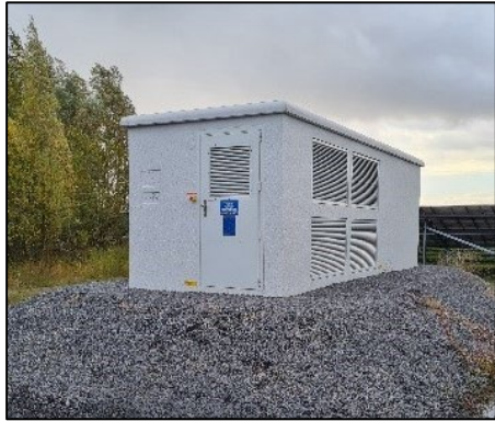
Exemple de poste de transformation
