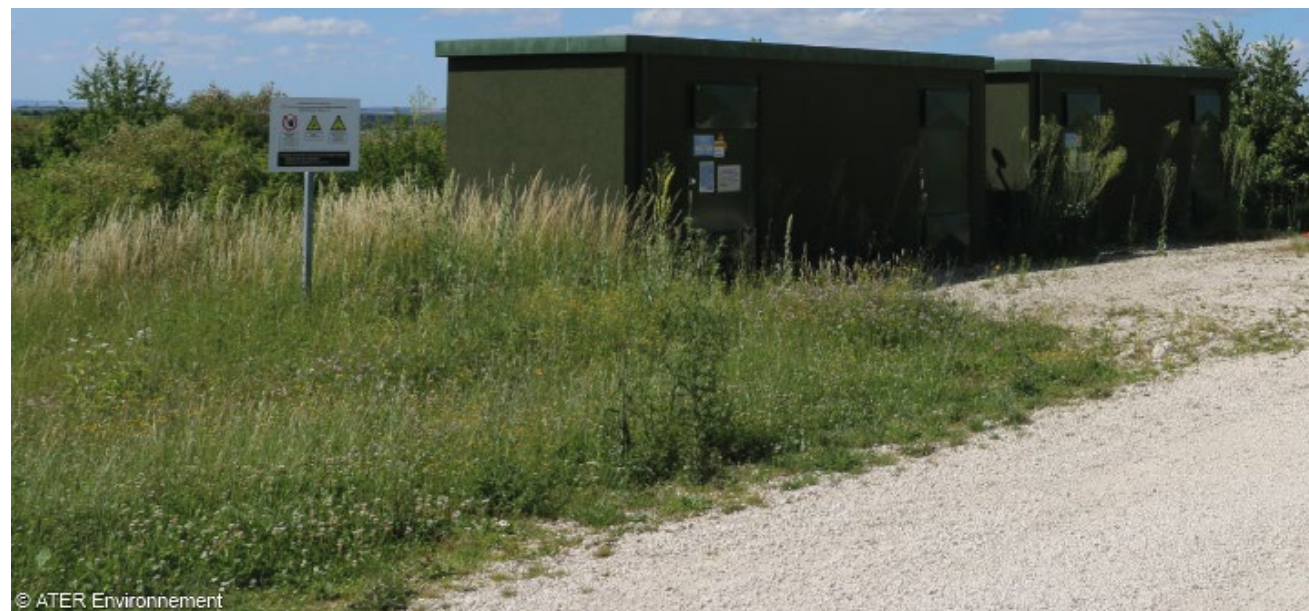
Figure 21 : Illustration du poste de livraison
