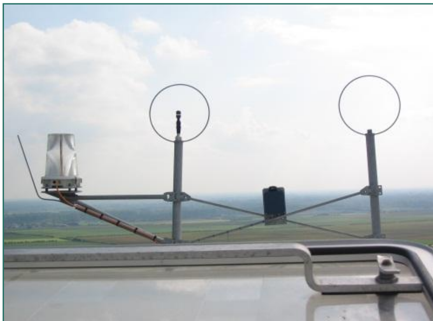
Figure 16 : Photographie d'un exemple de balisage aéronautique
