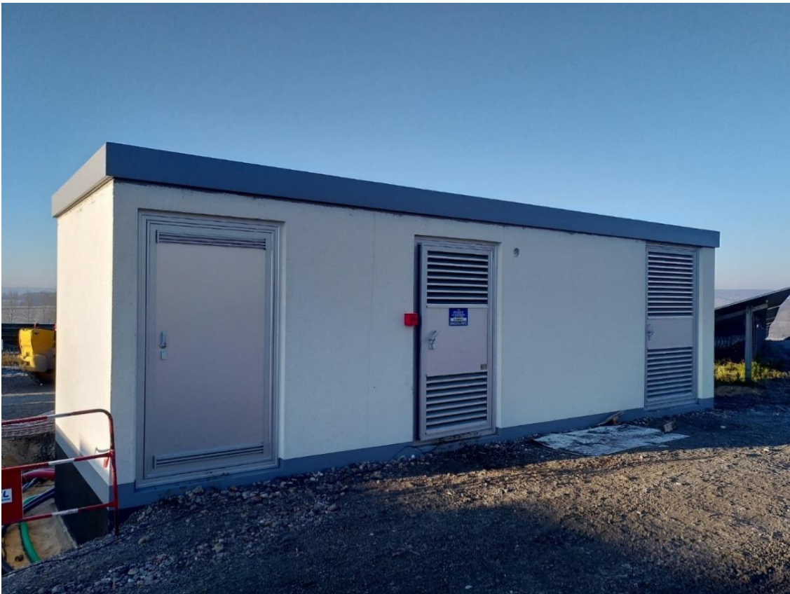
Figure 10 : Photographie d'un poste électrique (livraison/transformation)
