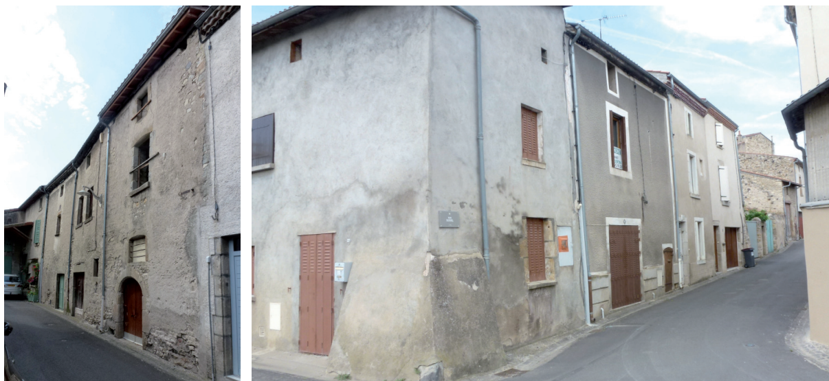
alternances d'aspects : dégradé des enduits
