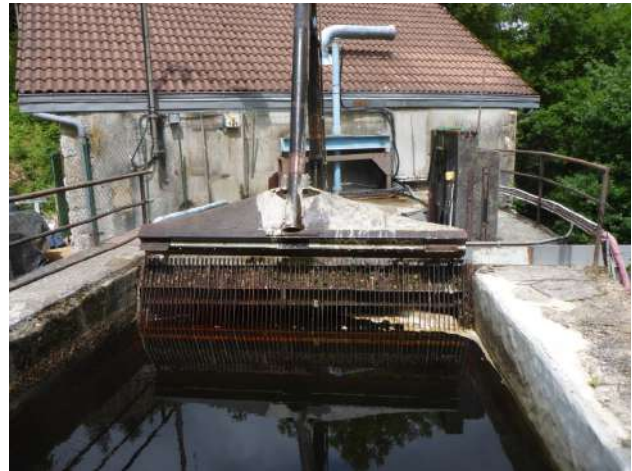
Grille en aval du canal d'amenée - HYDRO-M juin 2020
