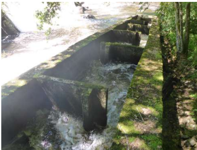
Passe à poissons - HYDRO-M 2018
