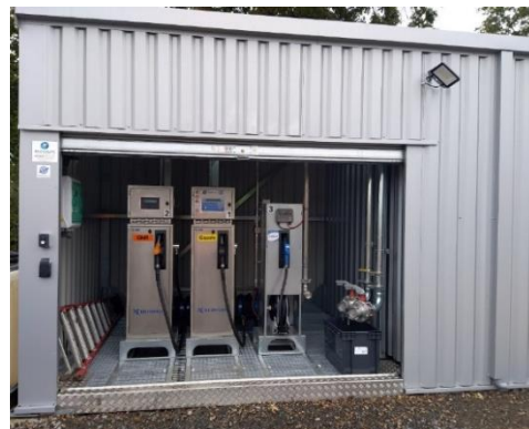
Illustration 18 : zone de distribution de carburant et Ad Blue (photo site 10/2024)
