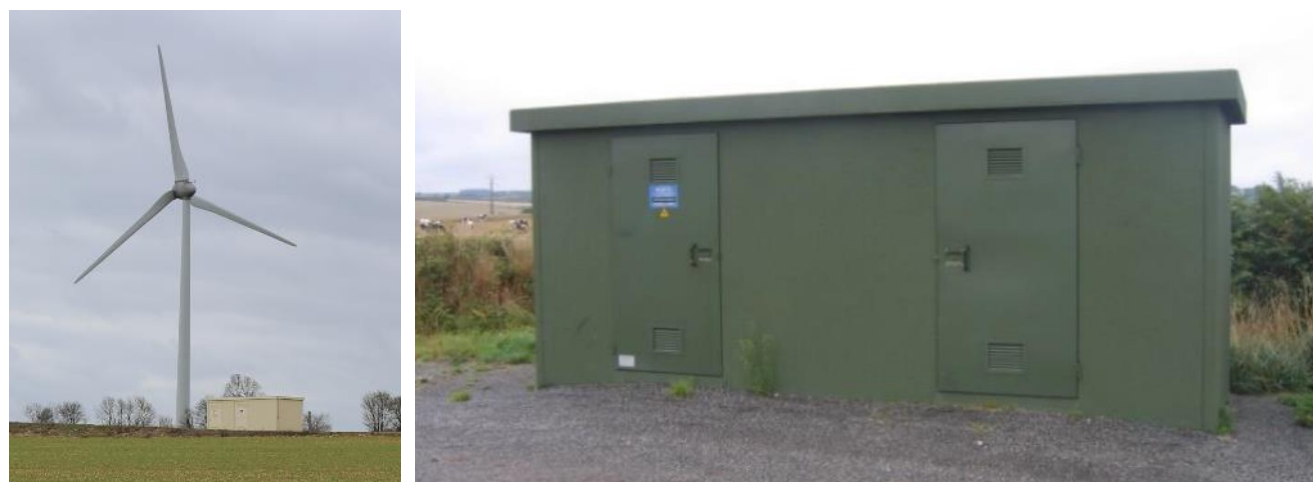
Exemples de poste de livraison électrique
