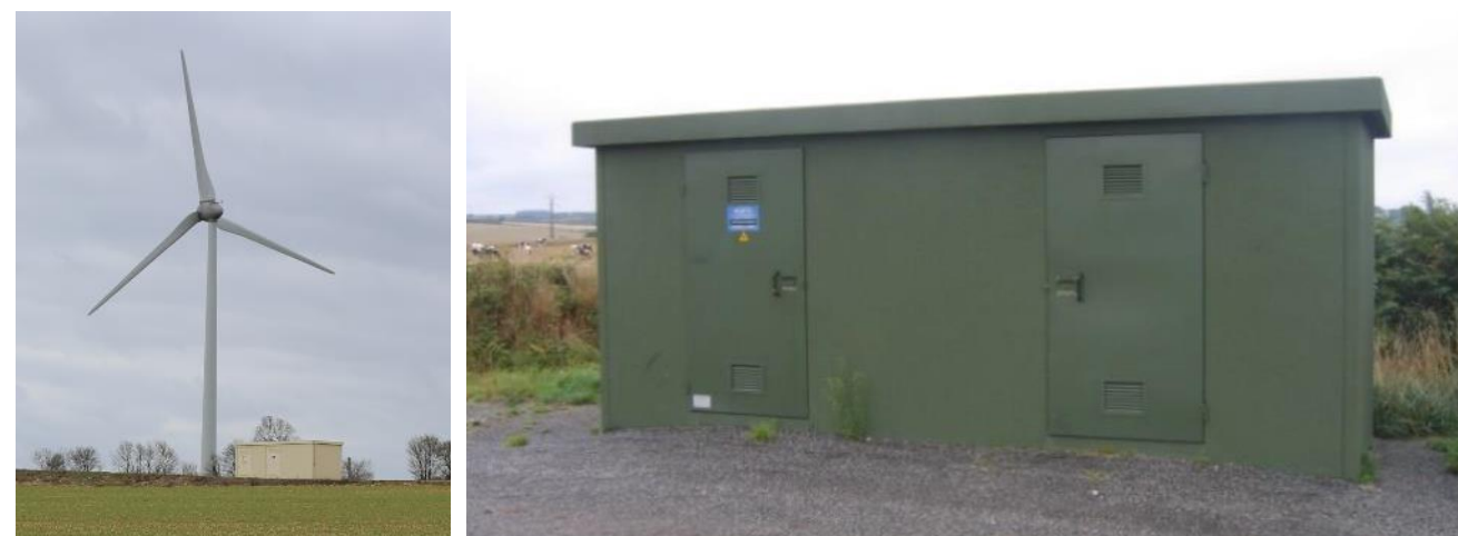
Exemples de poste de livraison électrique
