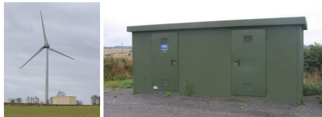
Photo 5 : exemples de poste de livraison électrique
