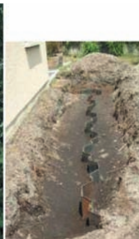
Figure 27 Écran métallique (Source Socabat)
