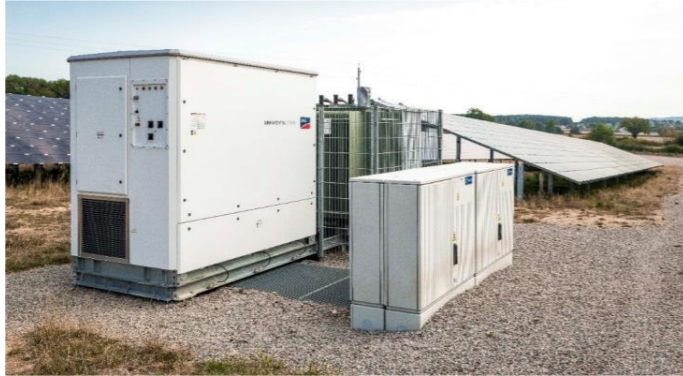
Photo 22 : Exemple de poste « outdoor » comportant un onduleur centralisé et un transformateur, centrale JPEE de Saint-Eusèbe (70) (source : JPEE)
