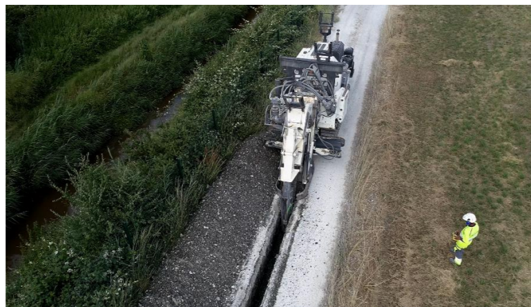
Photo 28 : Forage d'une tranchée pour le passage de câbles HT (à droite) sur la centrale JPEE de Labarde (33) (source : JPEE)
