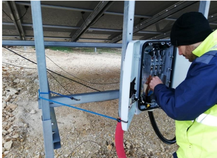
Photo 26 : Raccordement des onduleurs sur le parc JPEE de Thenon (24) (source : JPEE)
