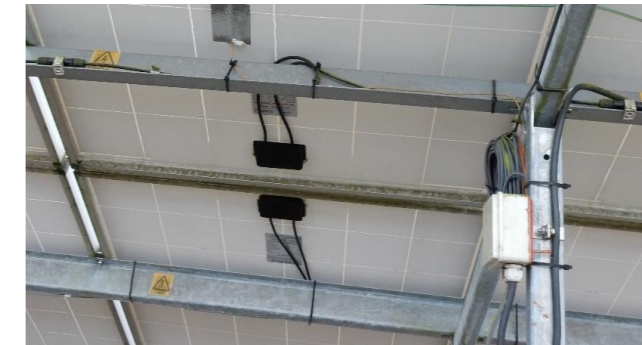
Photo 20 : Câbles solaires à l'arrière de modules, sur le parc JPEE de Casteljaloux (47) (source : JPEE)
