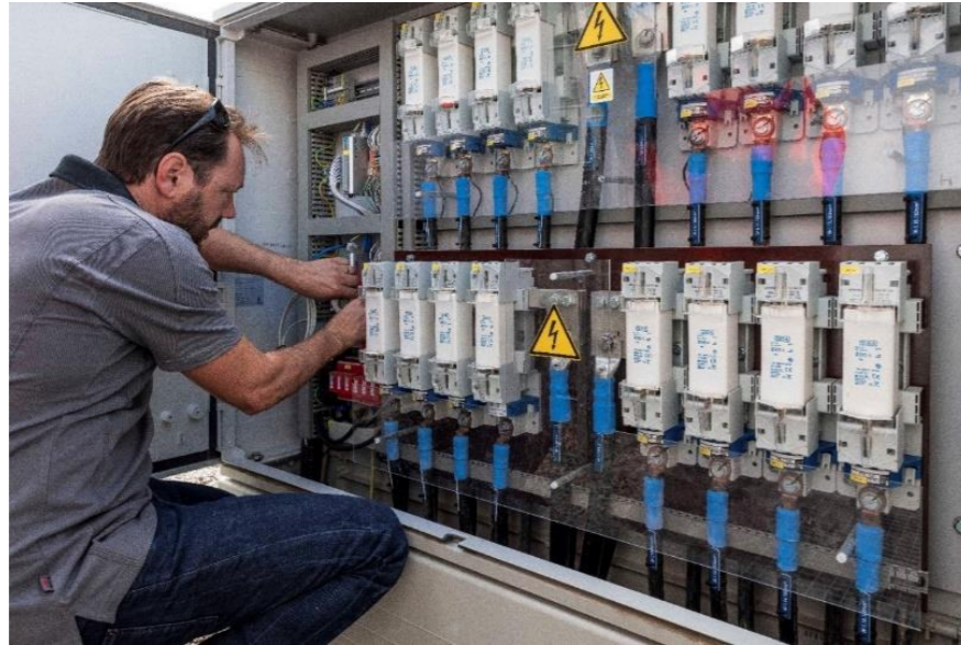
Photo 30 : Intervention dans une armoire DC, parc photovoltaïque de Saint-Eusèbe (71) (©Vincent Poillet – Groupe Caisse des Dépôts – 2022) (source : JPEE)
