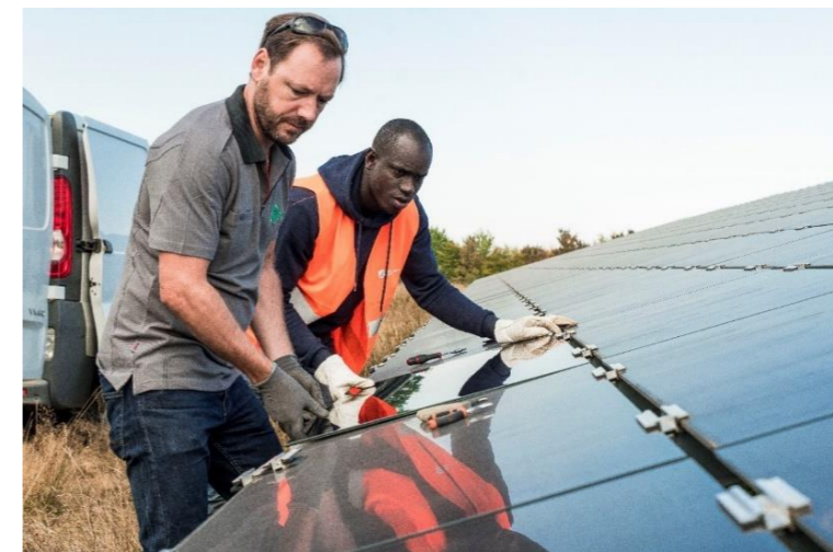
Photo 29 : Remplacement d'un module sur le parc solaire de Saint-Eusèbe (71) (©Vincent Poillet – Groupe Caisse des Dépôts – 2020) (source : JPEE)
