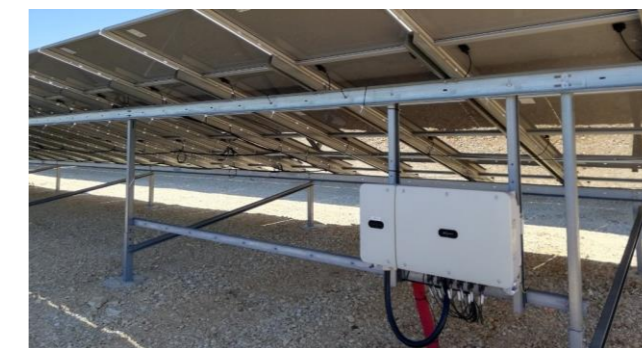
Photo 21 : Onduleur décentralisé sur le parc JPEE de Thenon (24) (source : JPEE)
