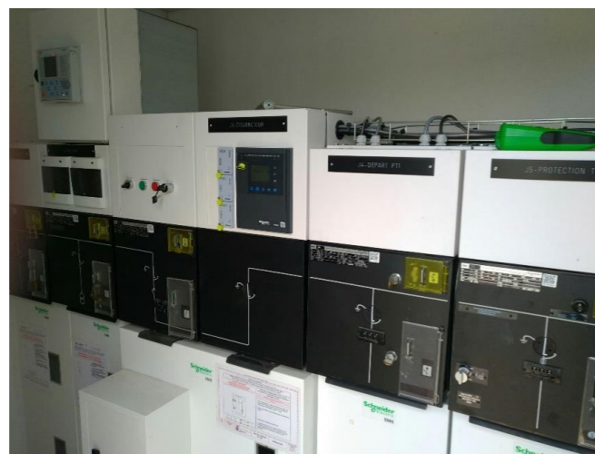
Photo 23 : Cellule HTA à l'intérieur du poste de livraison du parc JPEE de Saint-Loubès (33) (source : JPEE)
