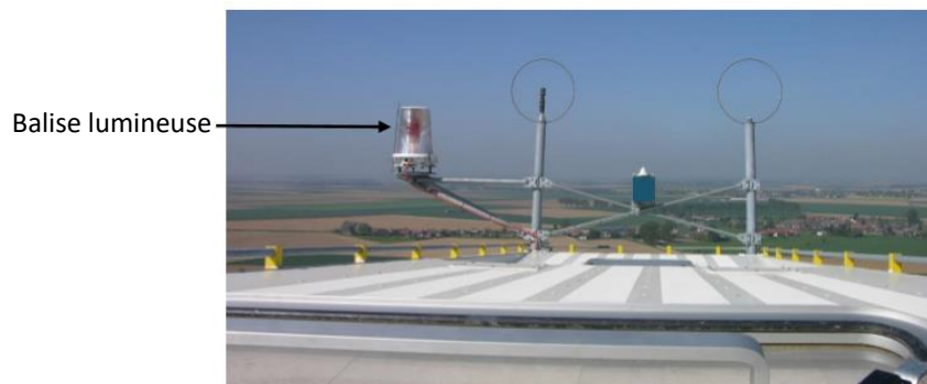
Figure 23: Système de balisage lumineux (Source : ECOTERA)
