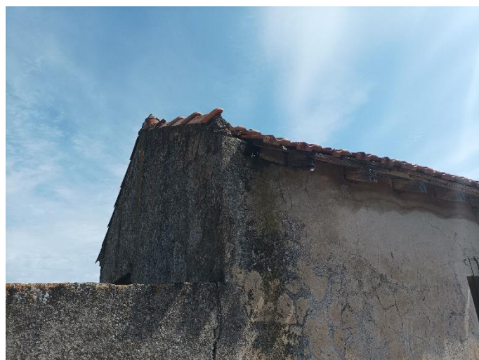
Fissures et trous sous le toit du cabanon désaffecté, entrées possibles de gîtes pour des chiroptères anthropophiles
