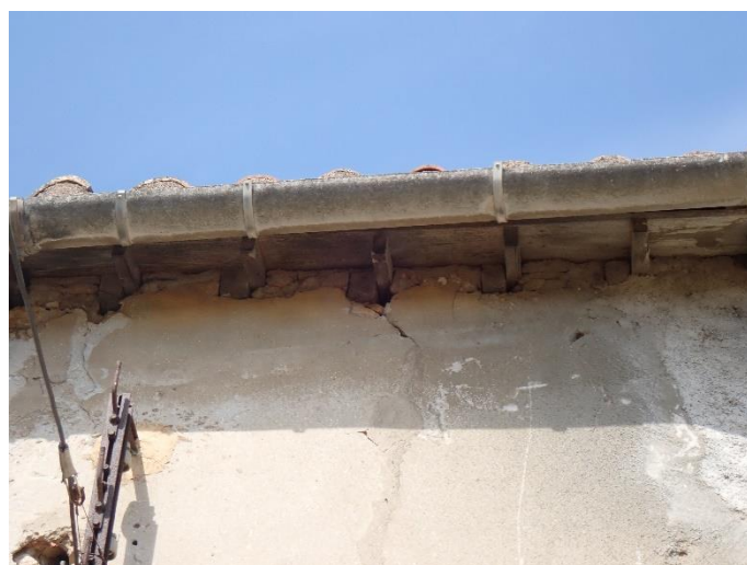
Fissures et trous sous les toits de la façade Sud-Ouest du mas de Chave, entrées probables de gîtes pour des chiroptères anthropophiles
