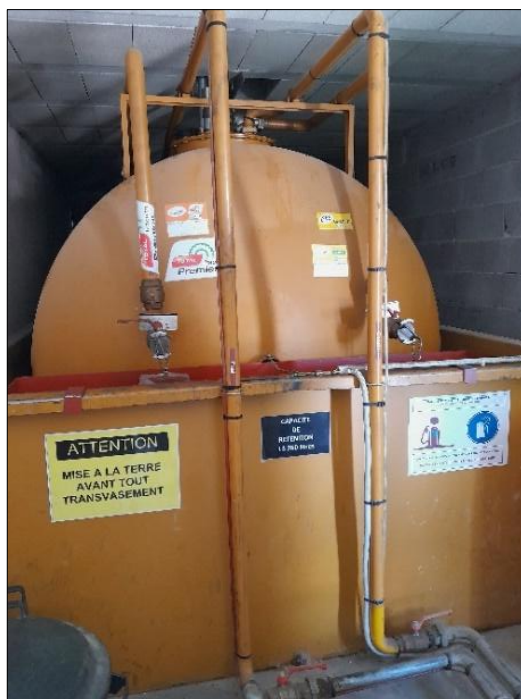
Figure 3 : Stockage de GNR et gasoil sur rétention (ENCEM)
