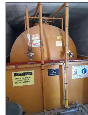
Cuve de carburant (ENCEM)
