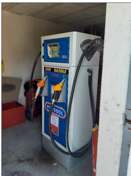
Figure 36 : Poste de distribution de GNR et gasoil (ENCEM)
