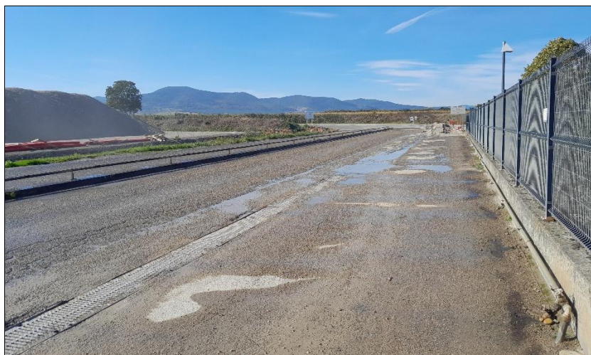
Figure 35 : Sprinklers sur la voie d'accès au site (ENCEM)
