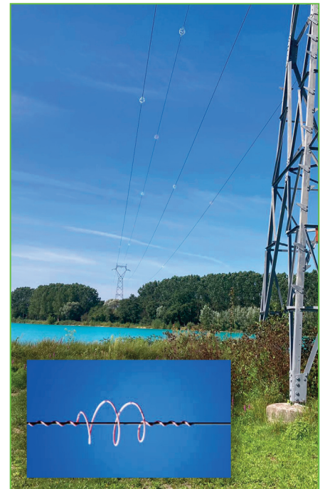
Système de balisage avifaune sur la portée de câbles 18-19 existante
