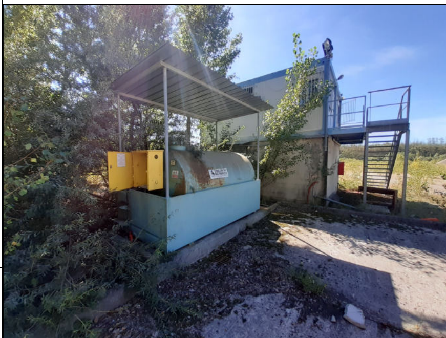
Vue 3 : Cuve + locaux + aire étanche
