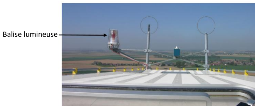
Figure 24: Système de balisage lumineux (Source : ECOTERA)
