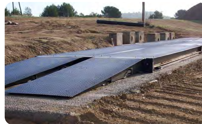
Exemple de pont-bascule
