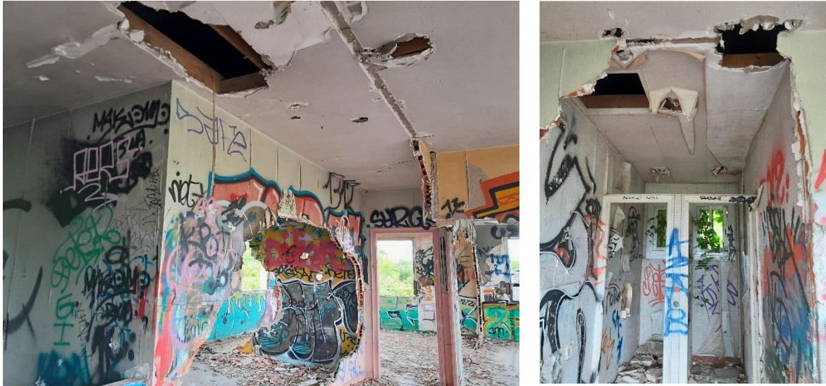
Figure 2 : clichés du sous-plafond dégradé - TBM environnement 2025
