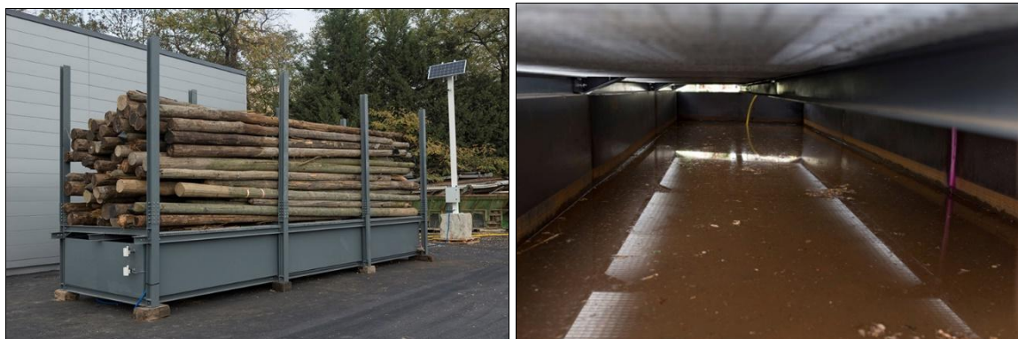
Figure 11 : Rack de stockage de bois C et sa rétention
