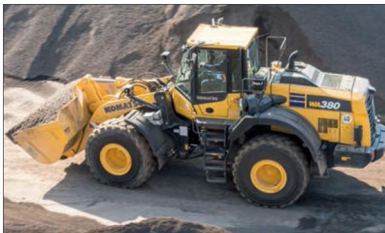
Figure 8 : Type de chargeur utilisé sur le site
