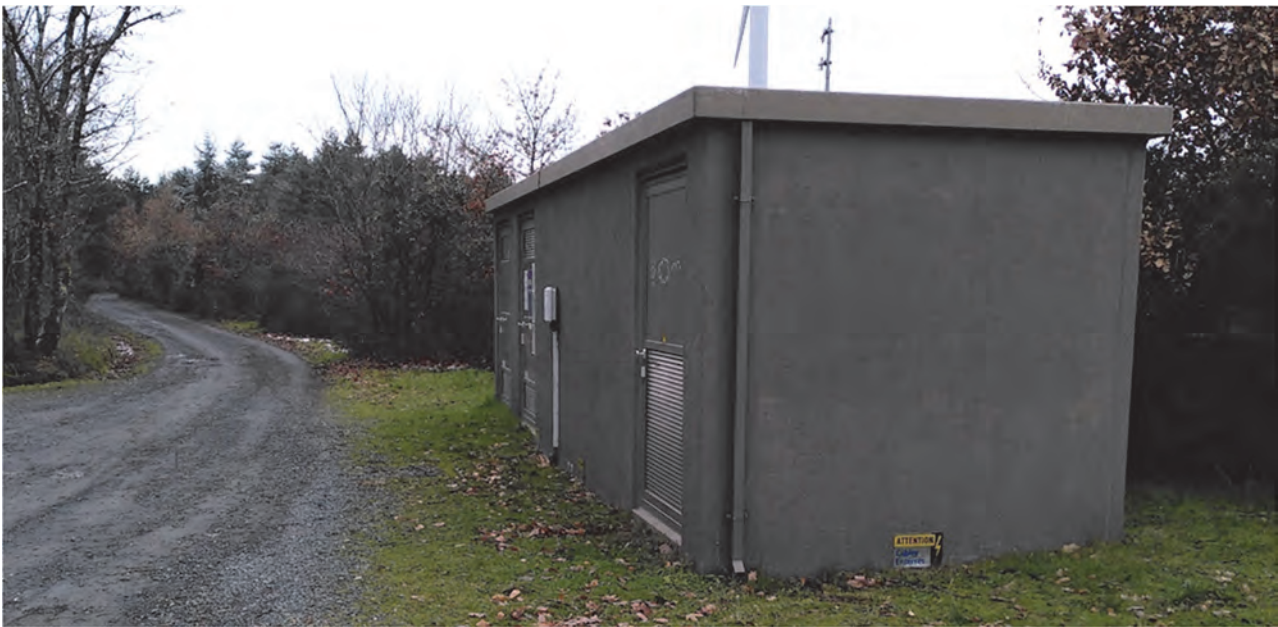
Illustration 41 : poste de livraison actuel du parc éolien de Cuq-Serviès (Source ABO Energy)
