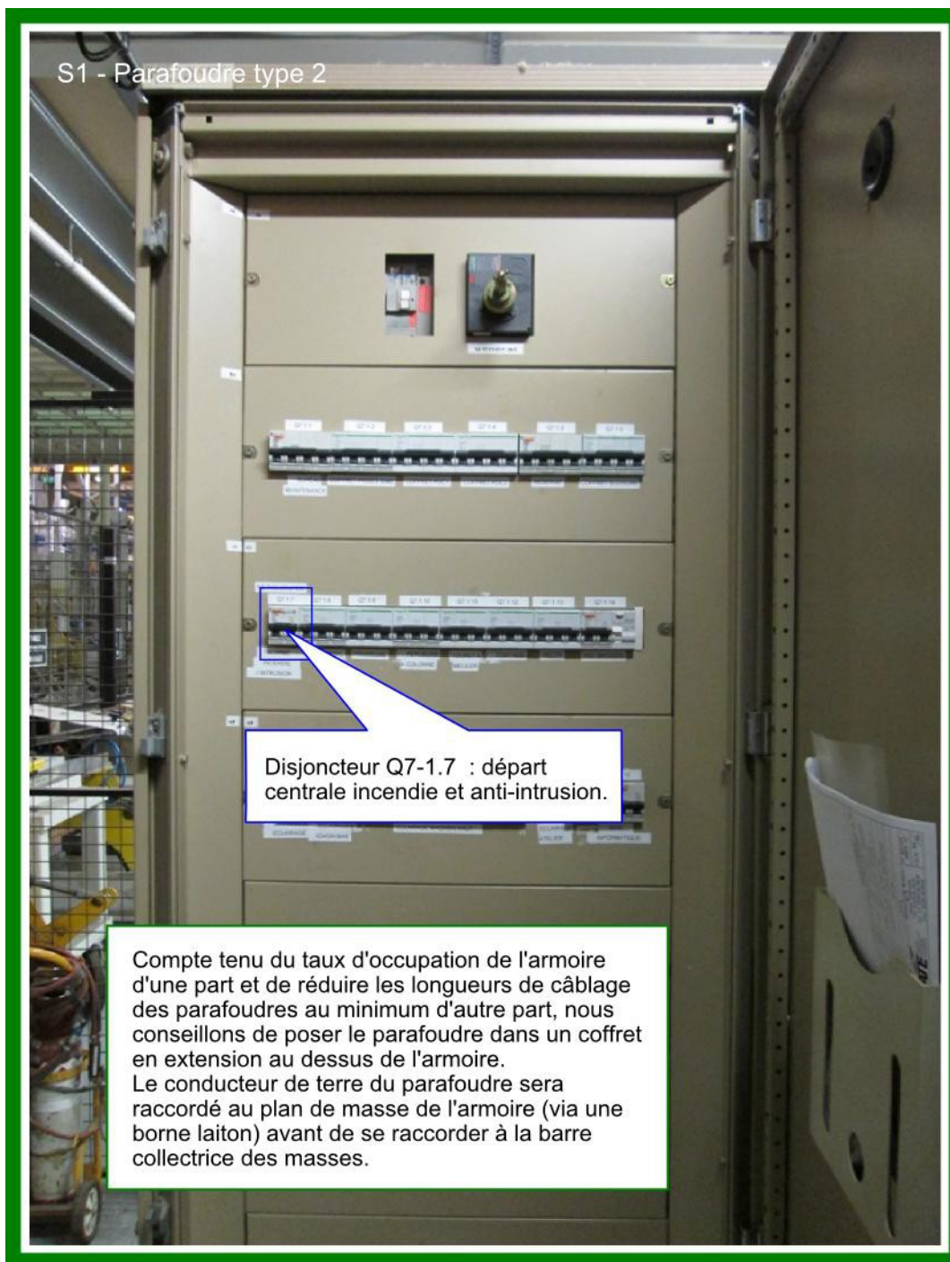
Illustration 6: S1, protection de l'armoire électrique
