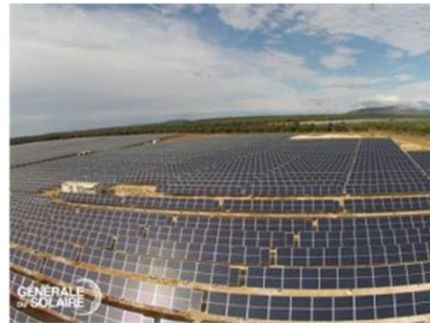
Centrale de Belvezet, Gard
