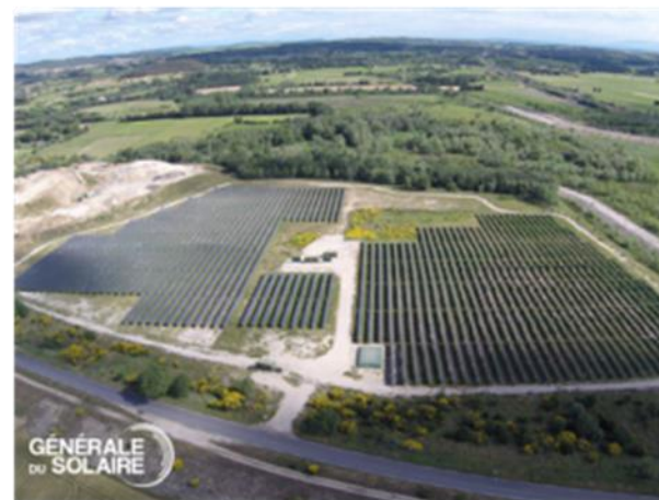
Centrale de Pujot, Gard
