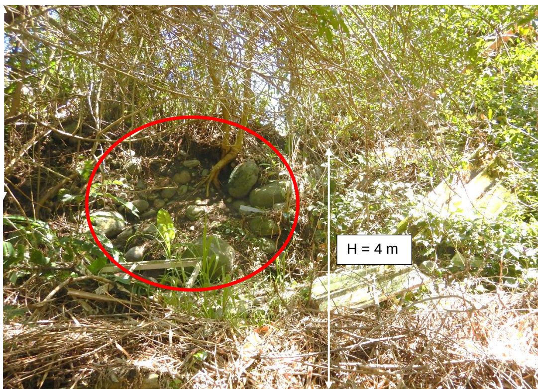
Figure 15 – Evidences d'instabilités récentes au sein du talus constitué d'alluvions grossières non consolidées et facilement érodables.
