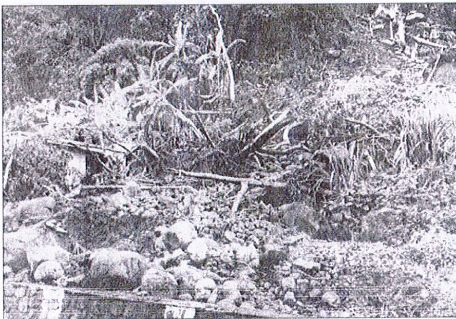
Un important glissement de terrain a eu lieu à la Rivière du Mât les Hauts lundi
