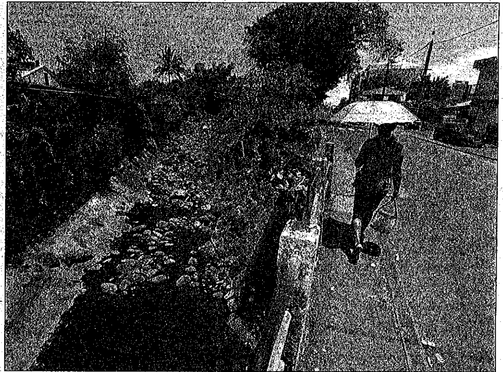
Le pont Auguste est l'un des principaux obstacles à l'écoulement d'une crue centennale de la ravine Sèche. (Photo E.M.)
