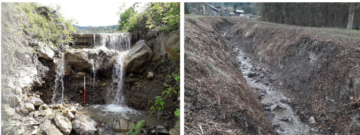
Figure 3 : État du torrent en aval de la RD182 - Photos ONF-RTM de mars 2022
