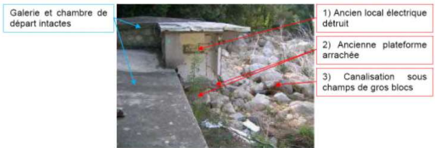
Dégâts occasionnés par la crue autour du bâtiment de captage (document IRH Ingénieur Conseil)
