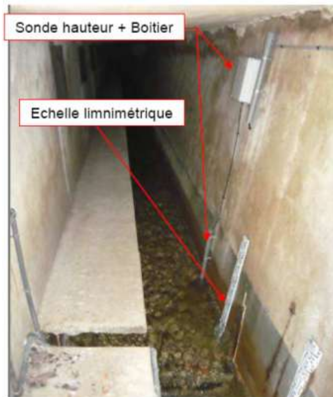
Galerie avec échelle limnimétrique et sonde de mesure (document IRH Ingénieur Conseil)
