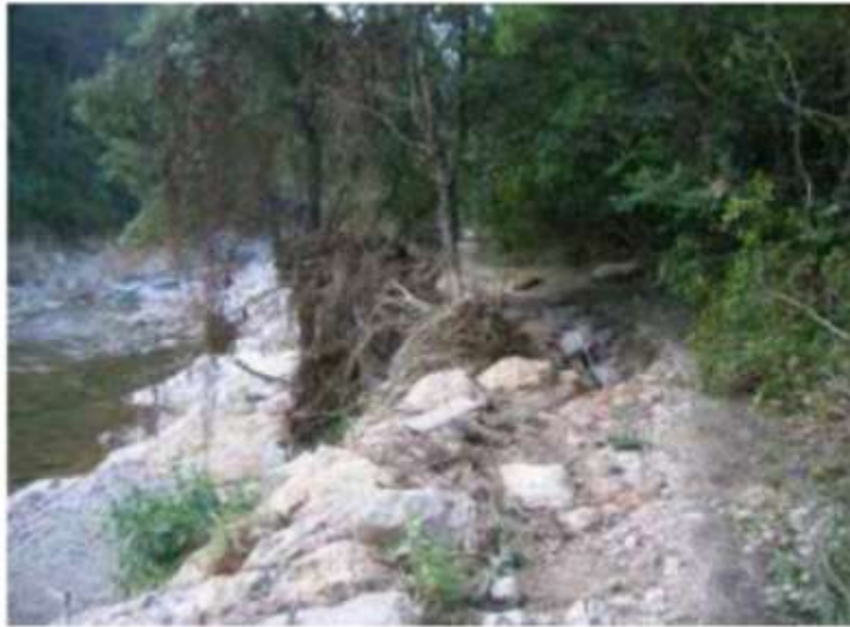
Plate-forme de la canalisation déstabilisée en aval de la traversée n°1
