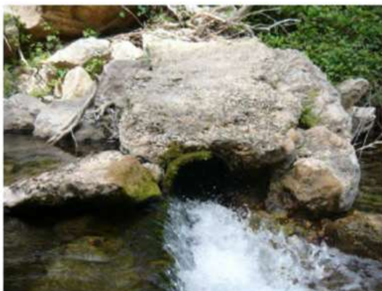
Seuil de la traversée n°1 arraché, canalisation d'adduction apparente
