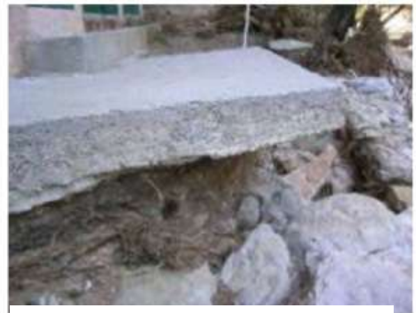
Erosion du terrain sous le local chlore (document IRH Ingénieur Conseil)
