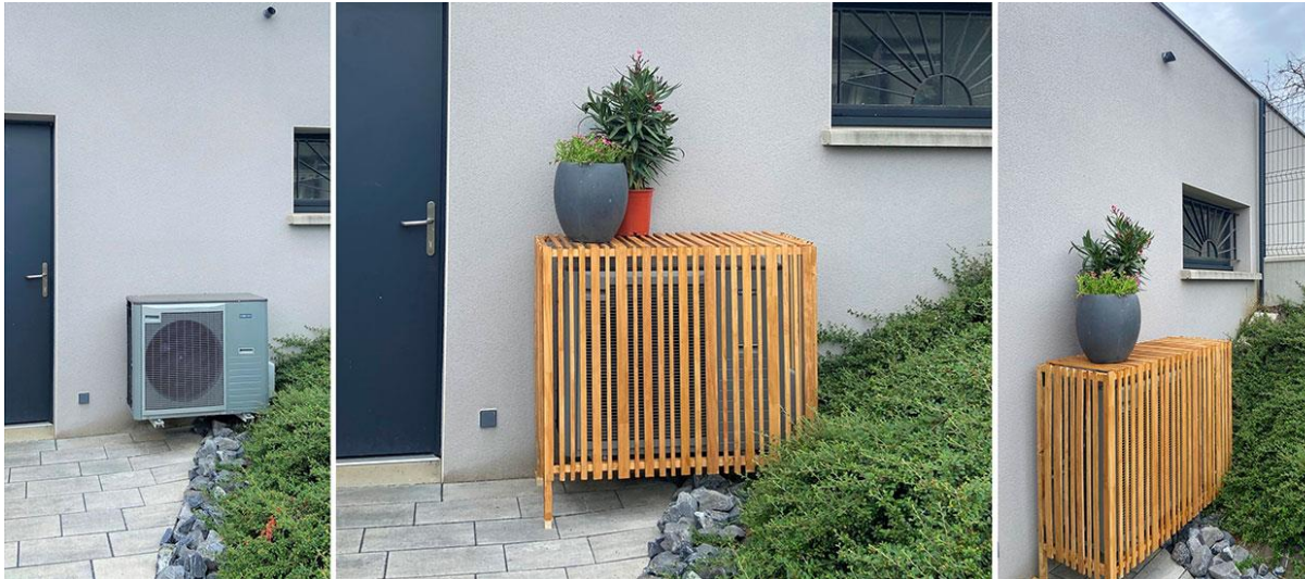
Exemple de cache utilisé pour masquer une pompe à chaleur (source : 18h39)
