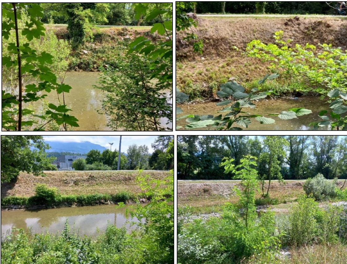
Figure 11 - Photographies de la digue (haut gauche : PKL 4.8, haut droite: PKL 4.8, bas gauche: PKL 5.7, bas droite PKL 5.5)
