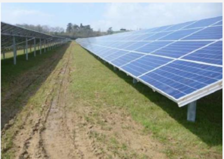
Centrale Solaire de CONDAM Département : Gers (32) Puissance électrique : 10 000 kWc Mise en service : Mars 2013
