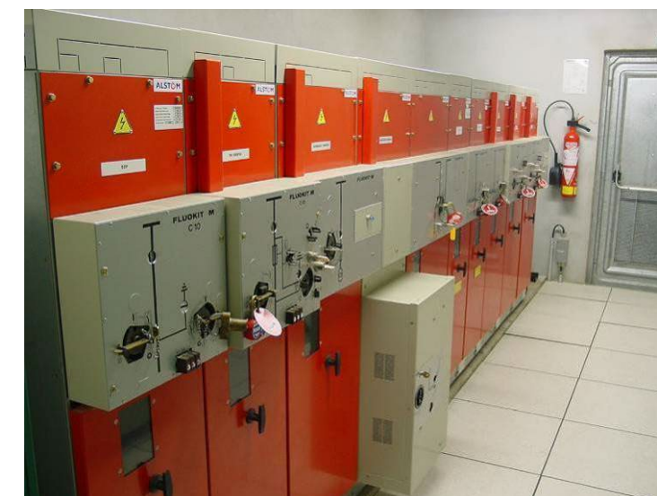
Illustration 12 : Intérieur d'un poste de livraison
