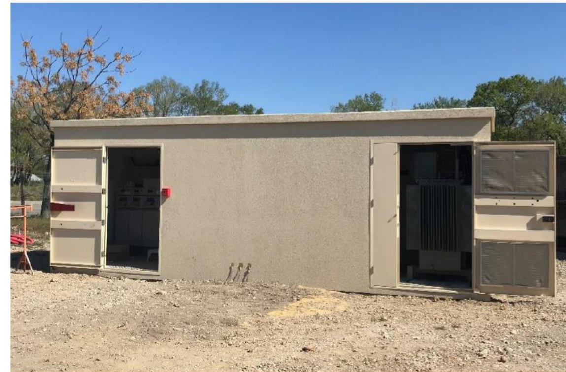
Figure 5 : Photographie d'un poste de livraison/transformation
