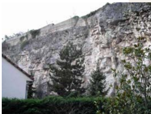
Falaise du chemin H.Latour à Dijon, potentiellement génératrice de chutes de blocs - PPRN Dijon, 2015
