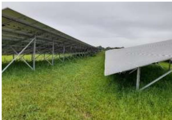
Reprise végétale sous les panneaux photovoltaïques
