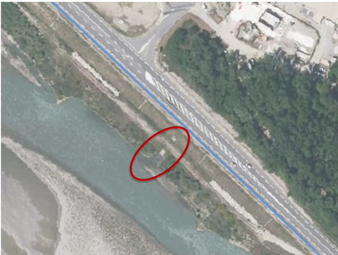
Illustration 45: Ouvrage 32 - zone d'aménagement A22 (ouvrage affouillé à l'aval)
