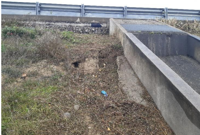
Ouvrage 26 – érosion en bordure de l'ouvrage
