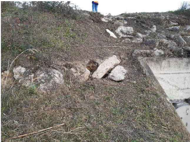
Ouvrage 15 – Érosion entre les blocs en tête d'ouvrage coté Durance
