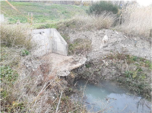
Ouvrage 32 – Affouillement en aval de l'ouvrage
