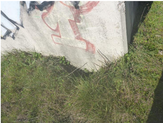
Ouvrage 9/10 – Affaissement en pied de l'ouvrage coté Durance
