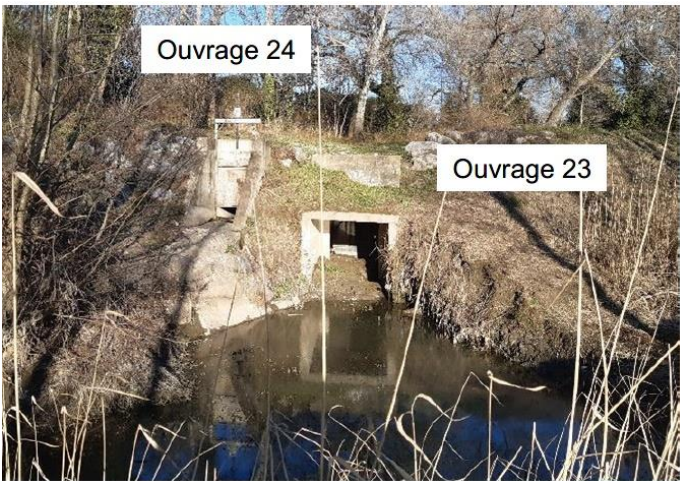
Ouvrage 23/24 – ouvrage 23 en partie colmaté
