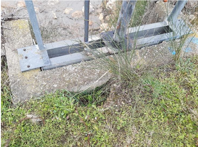
Ouvrage 27 – traces d'érosion en bordure de l'ouvrage
