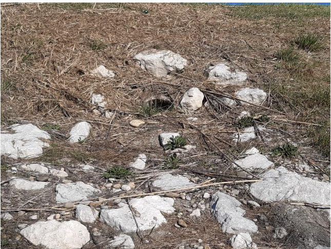
Ouvrage 19 – rejet non identifié, en partie colmaté
