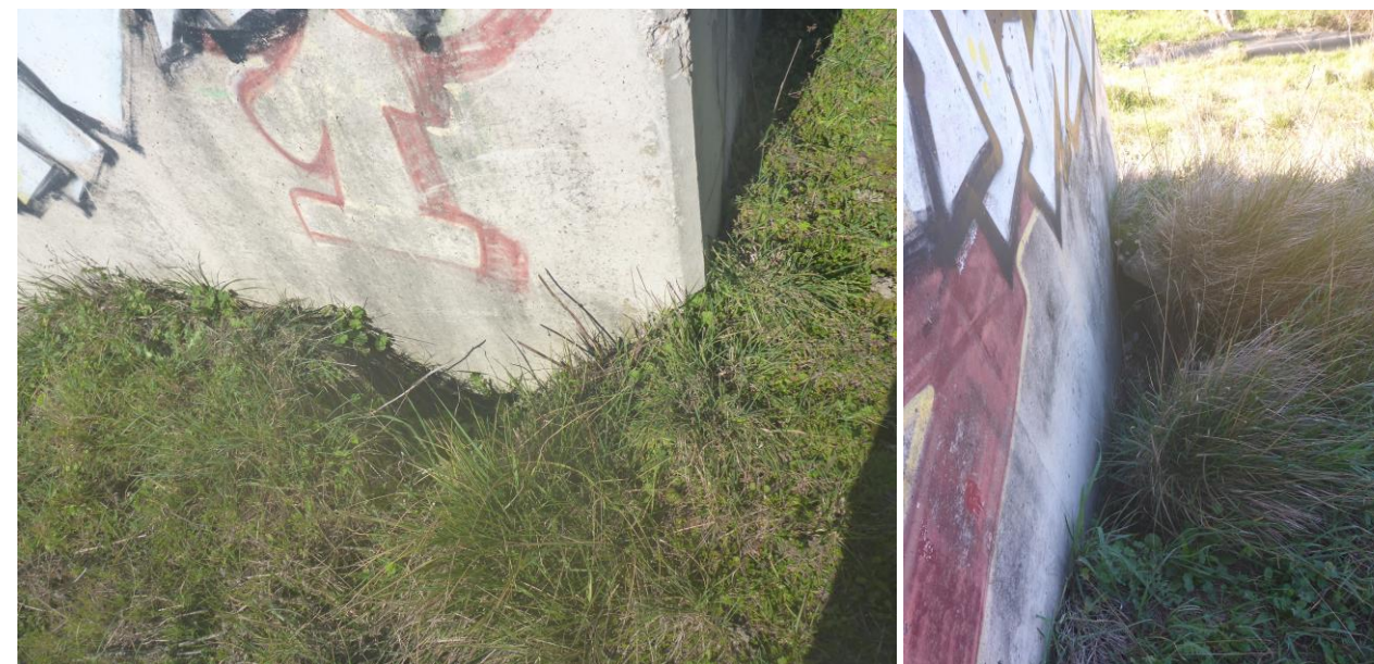
Illustration 67 : Affaissement des terrains en sortie de l'ouvrage sud du remblai RFF (photo du 12/02/2021)
