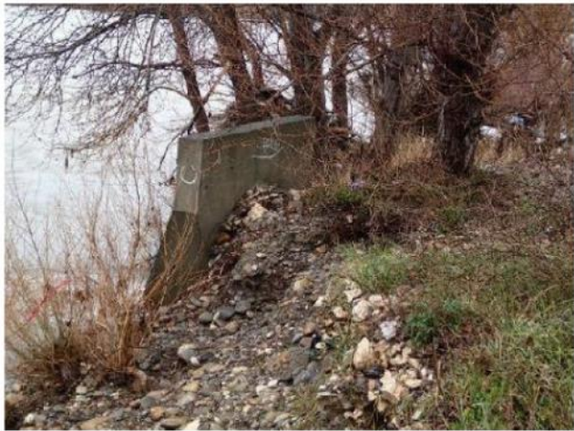
Ouvrage 12 – Érosion des terrains au niveau de la tête de l'ouvrage coté Durance
