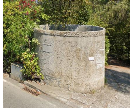
Citerne d'eau chemin de Saint Julien
